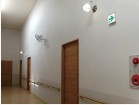
館内はエアコンとともに 扇風機を設置
